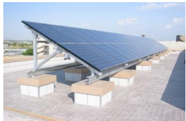
鋼製+アルミ製の架台
