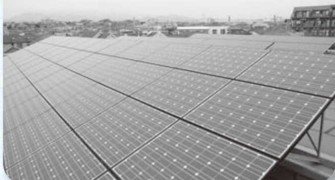
◀太陽光発電設備
