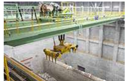
高座清掃施設組合処理施設
